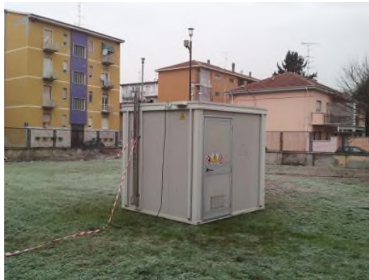
Cabina presso via Monte Grappa a Trino
