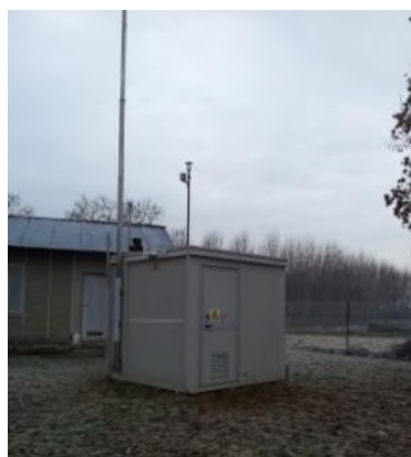
Cabina presso Proprietà Sogin
