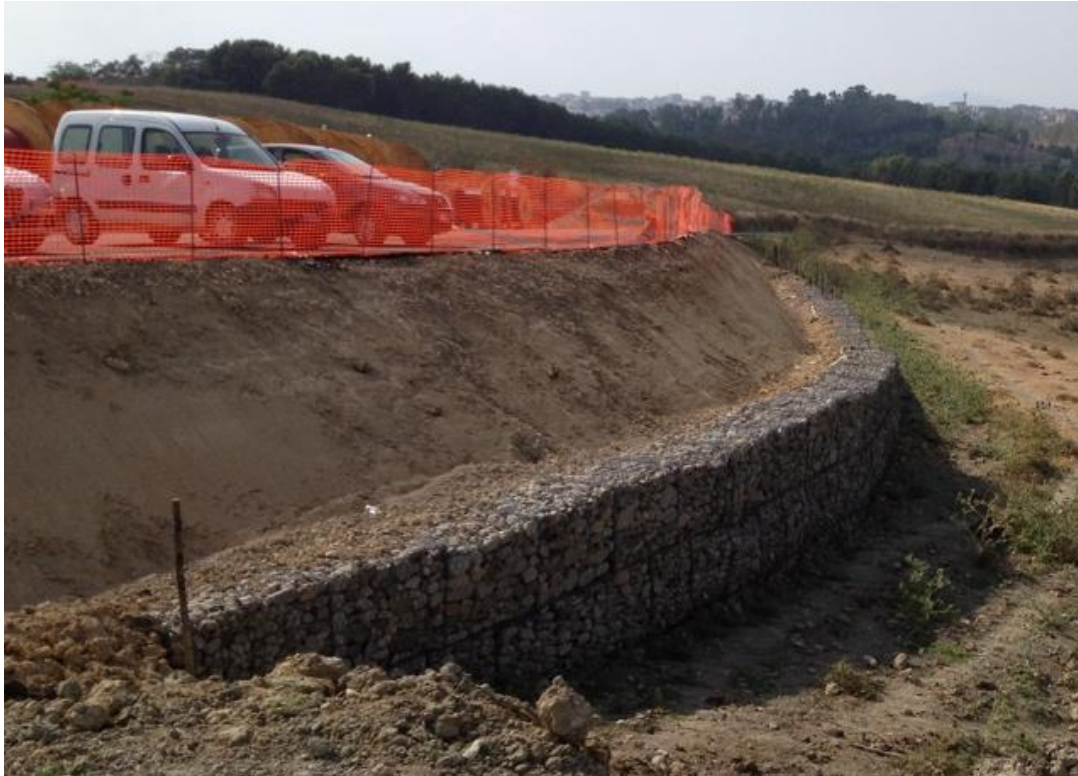
Figura 19 – Esempio di gabbionate a sostegno delle scarpate di rilevato di una piazzola di stoccaggio e montaggio
