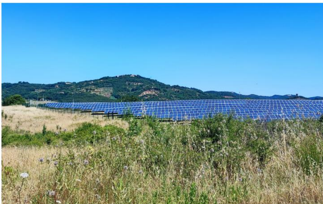
Figura 2.5-Vista del campo fotovoltaico esistente adiacente alla centrale e all'area oggetto del presente progetto
