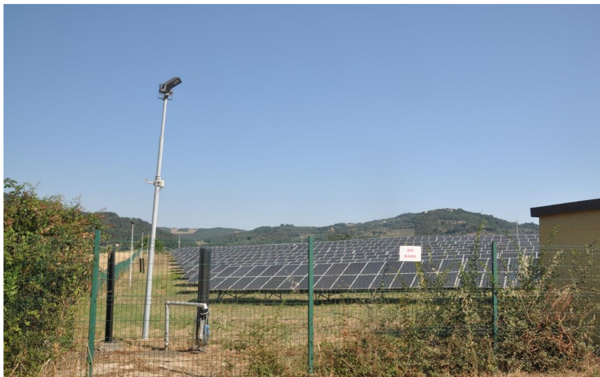
Figura 14 – Impianto fotovoltaico a confine con l'area del sito
