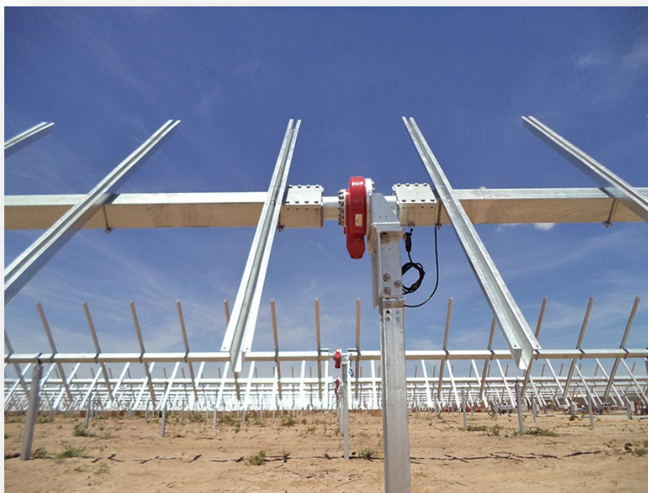
Figura 4 – Struttura dell'inseguitore solare monoassiale
