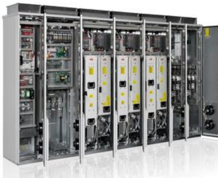
Figura 3. Esempio di inverter centralizzato.
