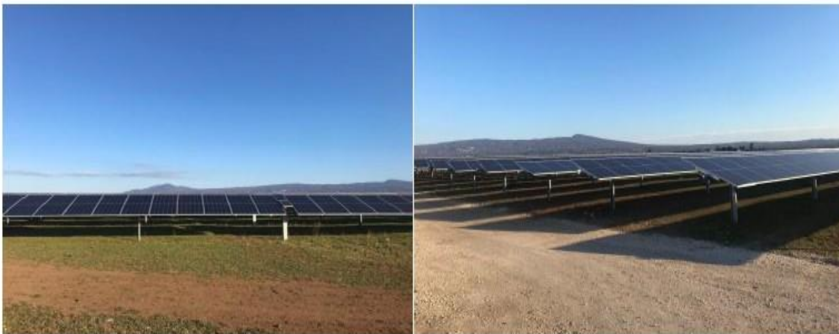
Figura 33: Esempi di impianti con tecnologia ad inseguimento tracker
