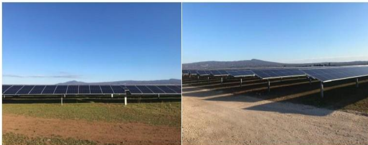
Figura 18: Esempi di impianti con tecnologia ad inseguimento tracker
