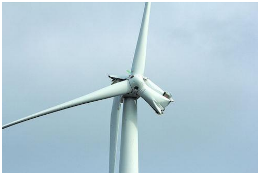
Figura 5-1 – Rottura parziale della pala senza distacco (Parco eolico DTE energy in Sigel Township, MICHIGAN)
