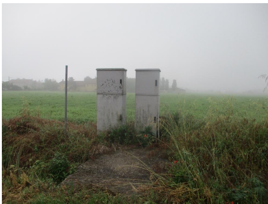
Fig. 6: Foto n° 4: Incrocio con linea elettrica (44°49'40.8"N, 8°44'04.2"E)
