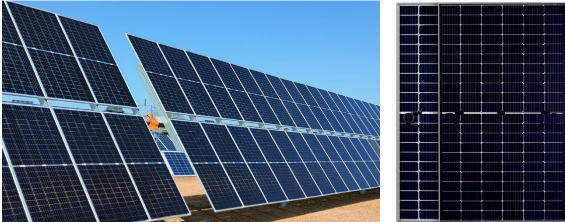
Moduli fotovoltaici su tracker mono assiali
