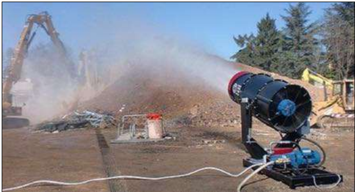
Figura 176: Sistemi di irrorazione con acqua delle aree di cantiere
