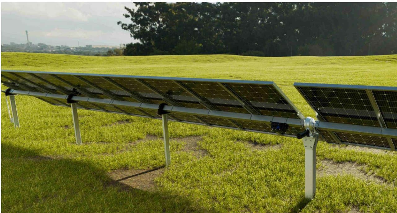
Esempio di palo del tracker infisso nel terreno
