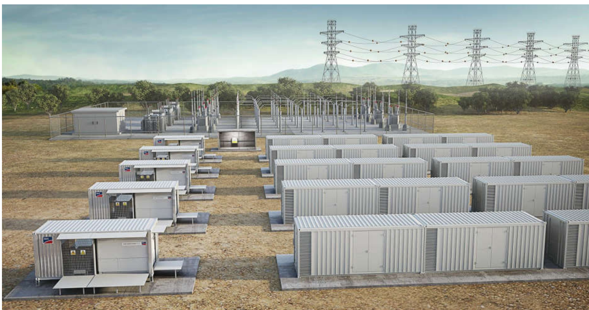
Figura 27: Immagine di repertorio impianto BESS
