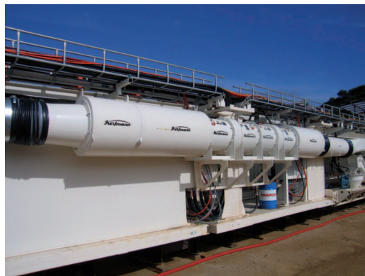
Foto 1 – Ventilatori in aspirazione.
