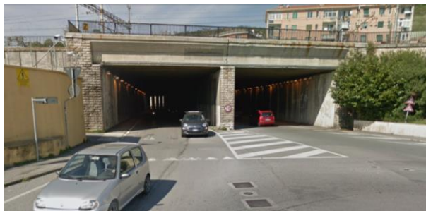
Figura 5 – Galleria insistente su Via Vittime di Brescia in prossimità della rotatoria con Via Risorgimento
