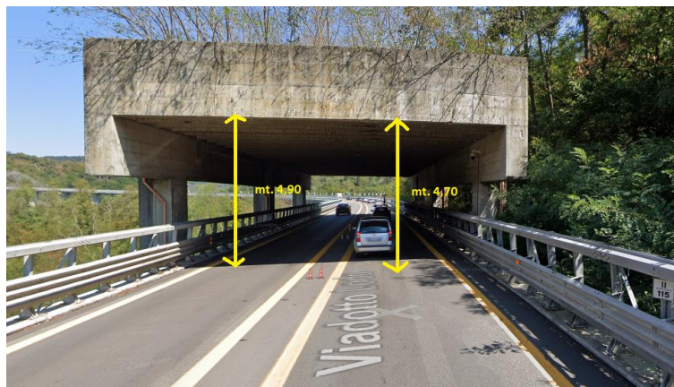
Figura 16 – Interferenza critica della struttura atta alla protezione della funivia ivi presente
