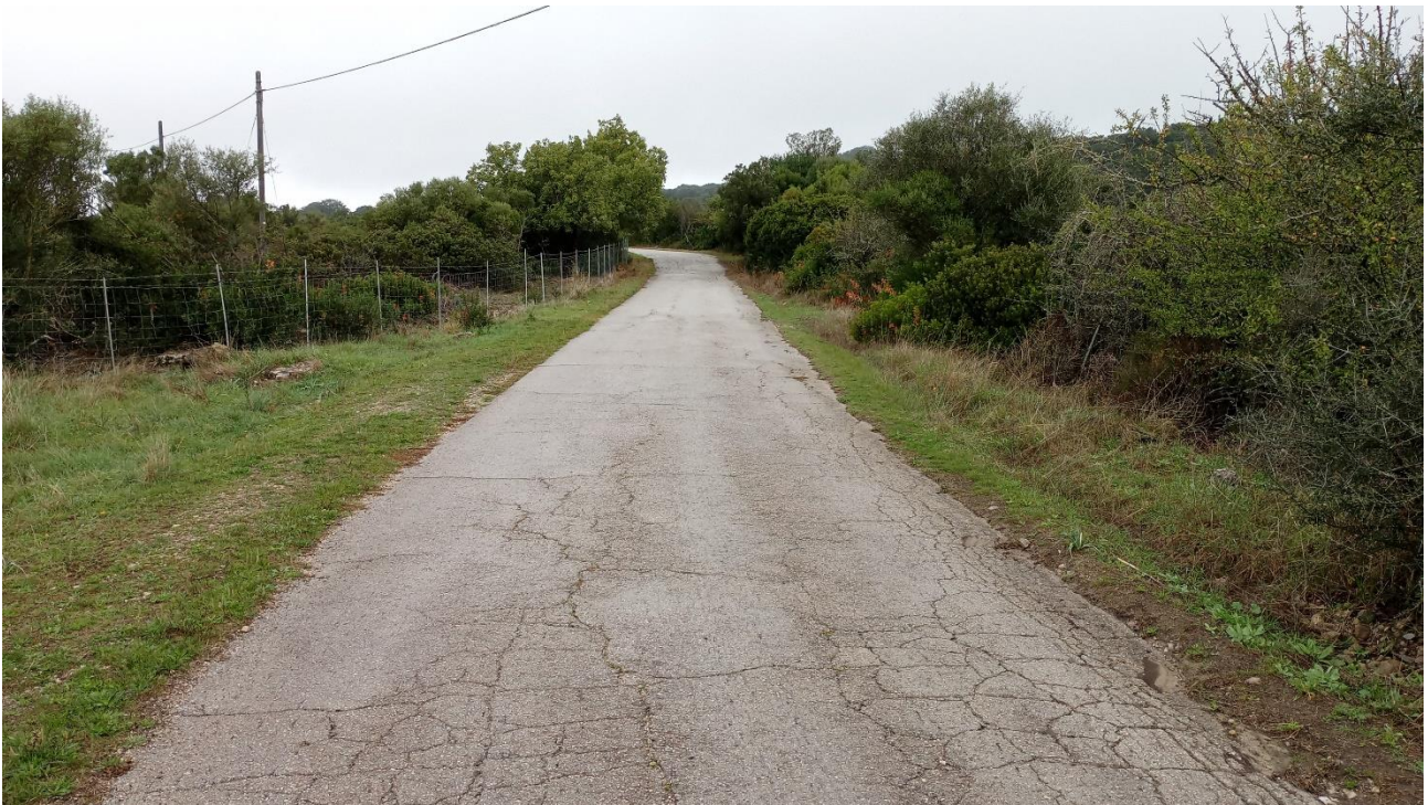
Figura 4.9 – Esistente tratto di viabilità esistente lungo il tracciato di accesso alla postazione WTG3 facente parte della viabilità di progetto (vista verso nord)
