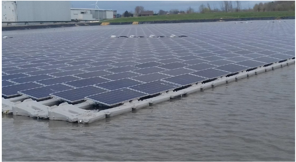
Figura 4-11 : esempio di struttura tipica porta-moduli
