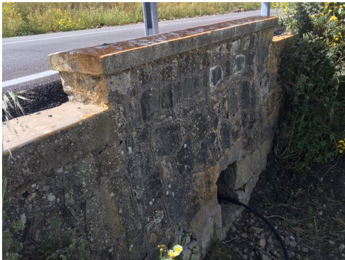
Figura 5.30 – Foto dell’elemento idrico non demaniale individuato su CTR 2012-2013 attraversato dal cavidotto 36 kV di collegamento tra la cabina di raccolta e trasformazione a 36 kV (“Area A”) e la cabina di sezionamento con collocazione su manufatti esistenti
