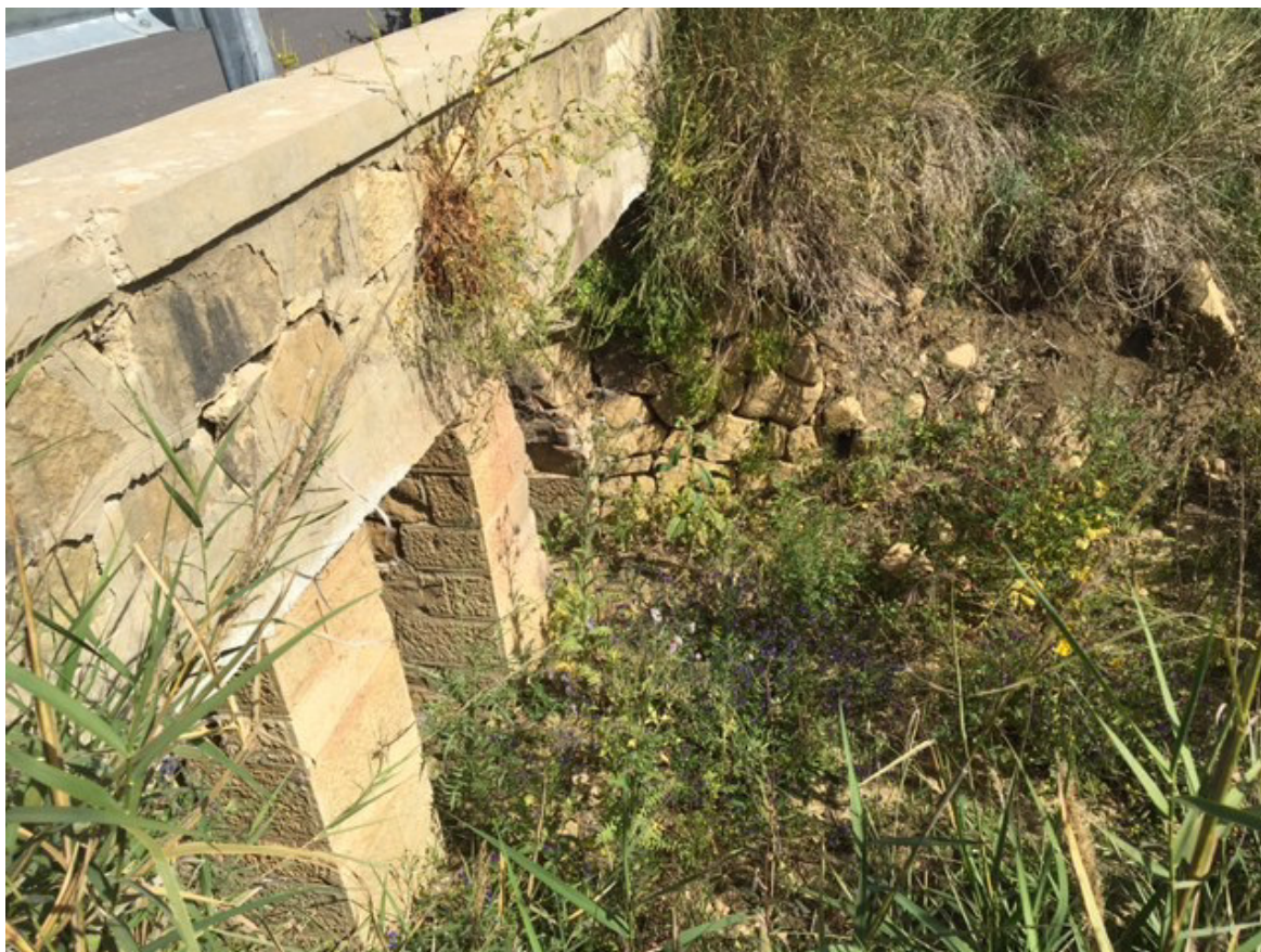
Figura 5.44 – Foto dell’elemento idrico non demaniale non individuato su CTR 2012-2013 attraversato dal cavidotto 36 kV di collegamento tra la cabina di raccolta e trasformazione a 36 kV (“Area A”) e la cabina di sezionamento con collocazione su manufatti esistenti
