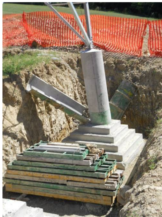
Figura 20: Realizzazione di fondazioni superficiali tipo CR per un sostegno a traliccio. Nell'immagine si può osservare una fondazione CR appena "scasserata". Si possono distinguere facilmente la parte inferiore a parallelepipedo tronco piramidale ed il colonnino di raccordo con la "base" del sostegno (immagine d'archivio)
