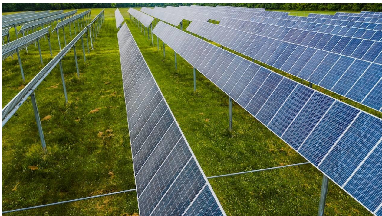
Figura: 36: Sostegno tipo strutture ad inseguimento solare ed esempio Moduli fotovoltaici
