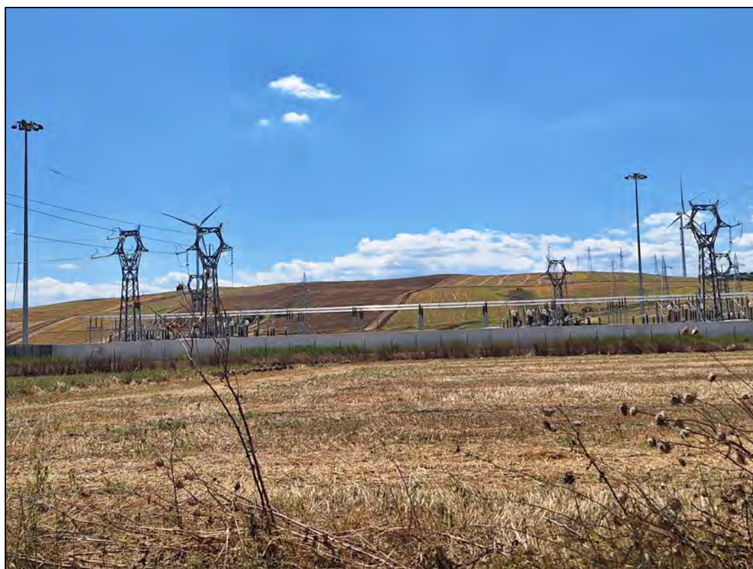
Figura 15 - Stazione Elettrica "SE Oppido Lucano 150/20 kV", punto di connessione
