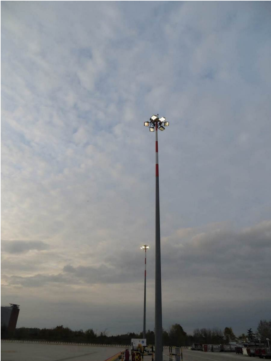
Figura C4-4 Il corpo illuminante utilizzato nelle torri faro a corona mobile del piazzale sosta aeromobili.
