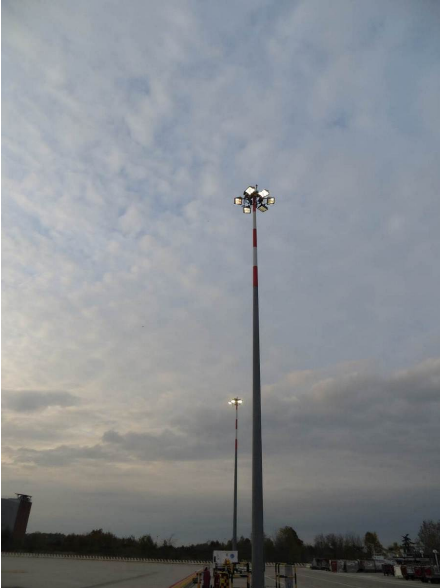
Figura D5-10 Il corpo illuminante utilizzato nelle torri faro a corona mobile del piazzale sosta aeromobili.
