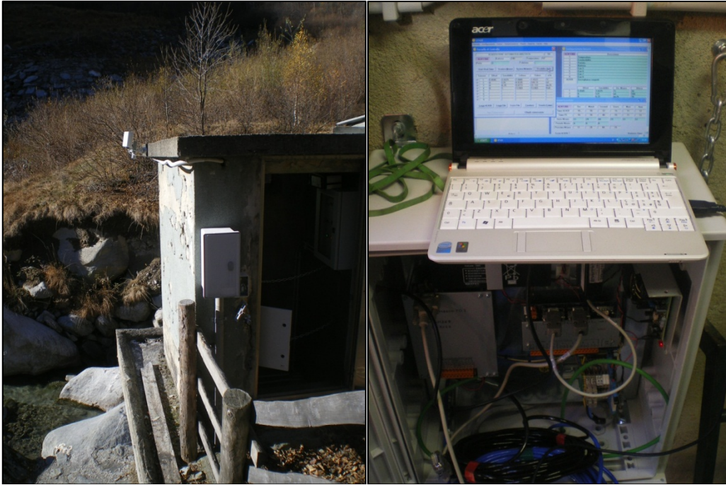
Figura 40 – Sistema di monitoraggio in continuo presso la sorgente AST_011-Boscocedrina. A sinistra antenna per accesso remoto; a destra: cabina interna alla captazione
