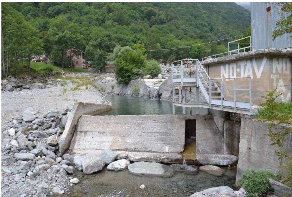
Figura 2.7: briglia e stazione di pompaggio per l'alimentazione del Canale Maria Bona (ad uso irriguo) a quota 1085m sul Clarea.
