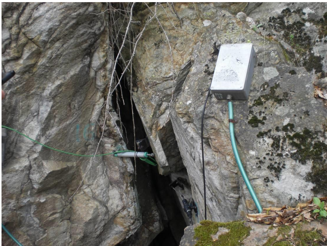
Fig. 5 – Misuratore di giunti (rete monitoraggio della Musinet).
