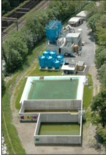
Figura 10 – Cantiere AlpTransit (Vigana) – Impianto di trattamento delle acque reflue di cantiere
