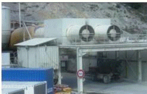
Figura 16 – Impianto di ventilazione – Particolare dei silenziatori e carter di insonorizzazione dei motori
