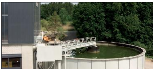
Figura 15 – Impianto di valorizzazione dei materiali di scavo – Particolare dell'impianto di trattamento delle acque
