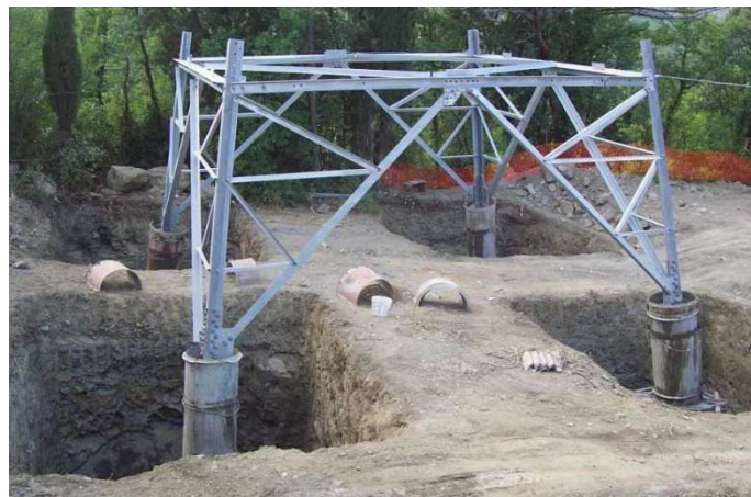
Figura 5-3: Realizzazione di fondazioni superficiali tipo CR per un sostegno a traliccio. Nell’immagine si possono osservare le quattro buche, la base del sostegno collegata alla fondazione tramite i “monconi” ed i casseri utilizzati per i quattro “colonnini”.
