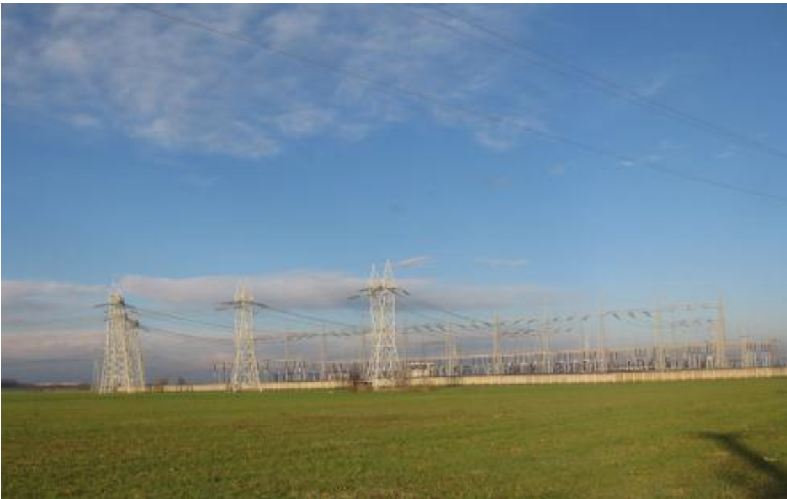
Foto 33: Stazione elettrica di Magliano Alpi
