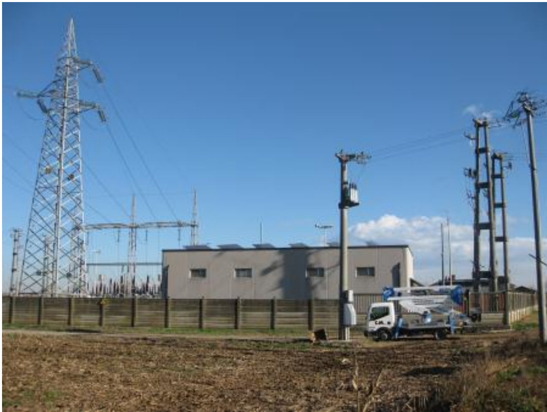
Foto 1: Cabina Primaria (CP) Enel di Fossano
