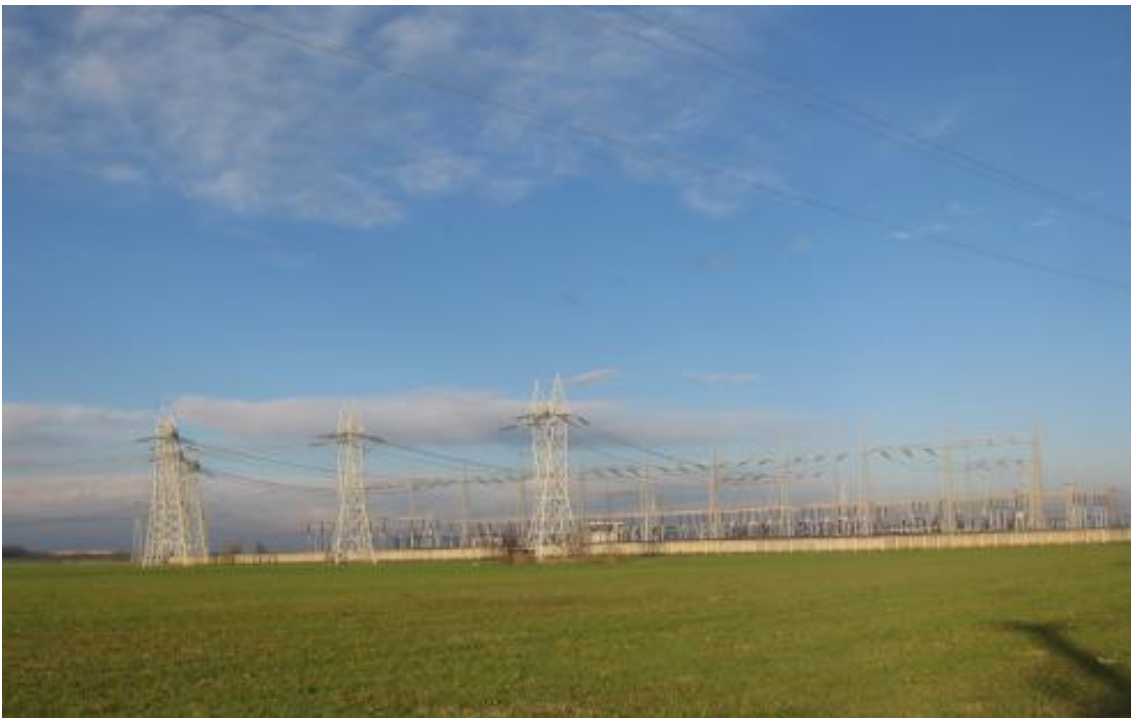
Foto 33: Stazione elettrica di Magliano Alpi
