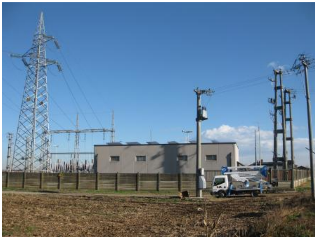
Foto 1: Cabina Primaria (CP) Enel di Fossano
