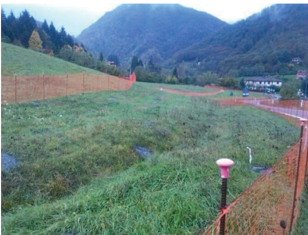
Canaletta per lo sgrondo di acque superficiali
