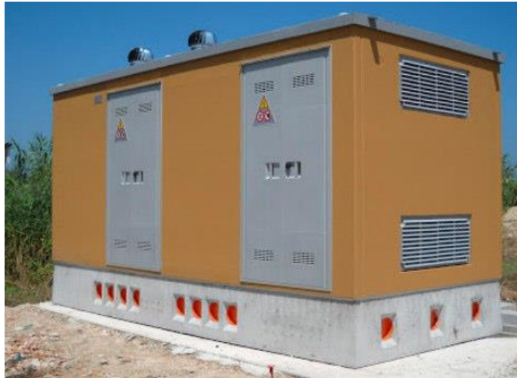
Figura 7- Esempio cabina prefabbricata in CAV
