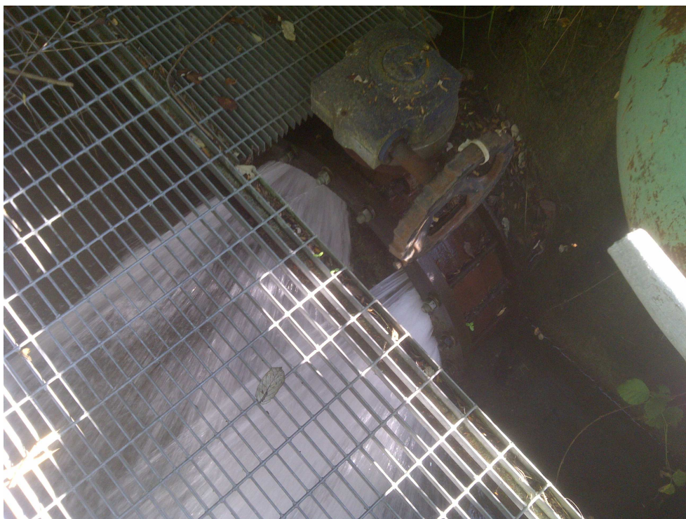
Foto 10: vista saracinesca alimentazione invaso
