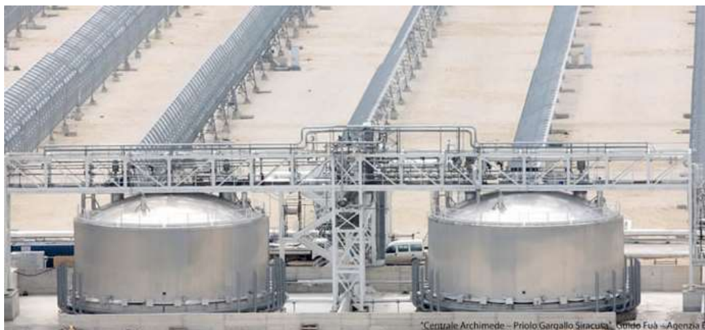
Serbatoi di Accumulo - Esempio
