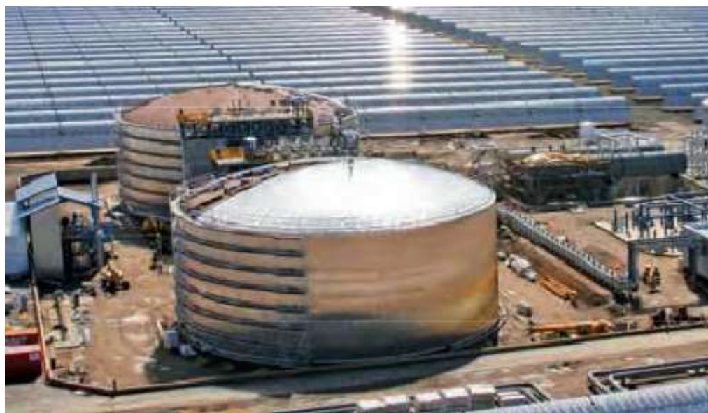
Serbatoi di Accumulo - Esempio
