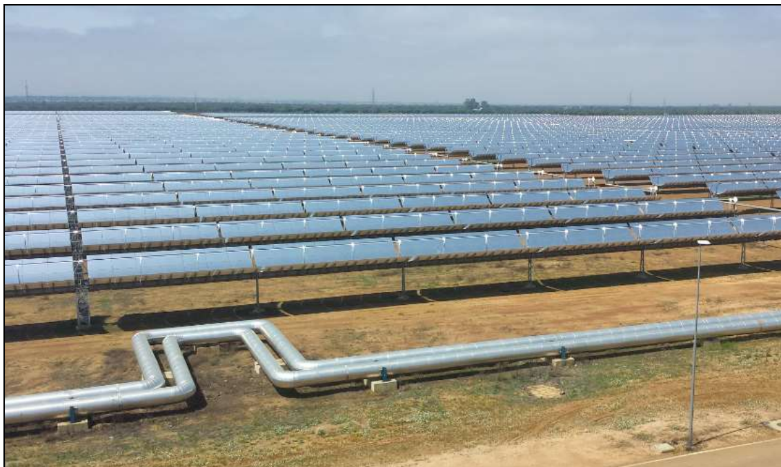
da Appendice 1 punto 4 - Figura 2: Impianto CSP esistente - Compensatori ad Omega
