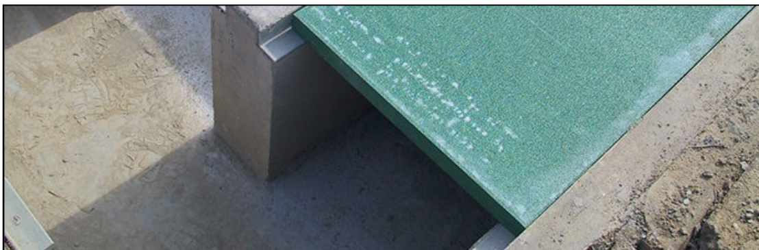
Figura 16: Esempio di copertura cunicolo cavi con PRFV
