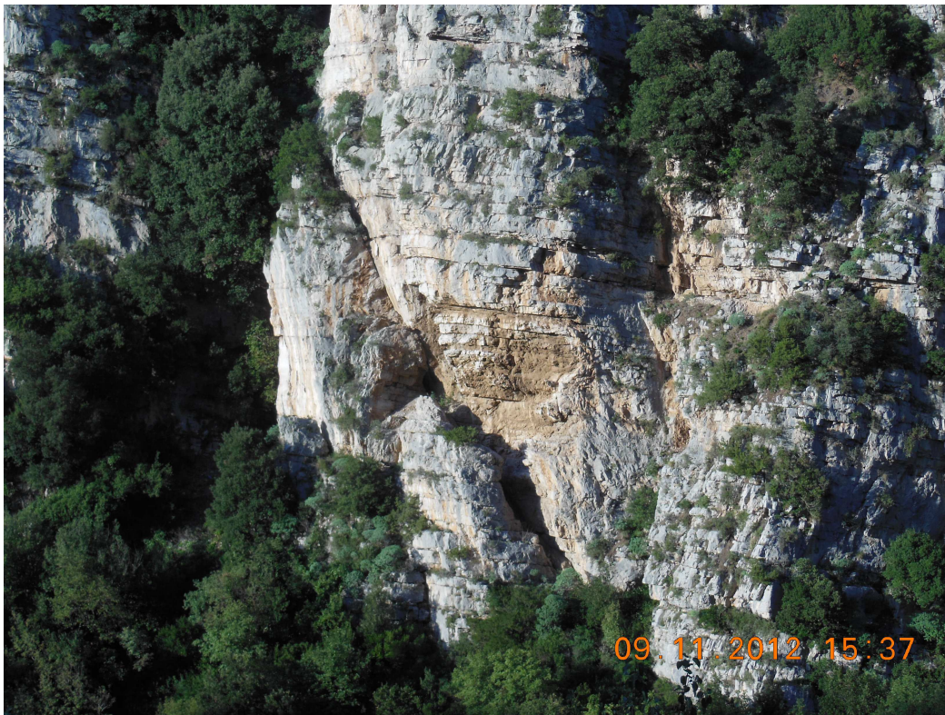
Foto 2: superficie di distacco di un blocco roccioso da una scarpata
