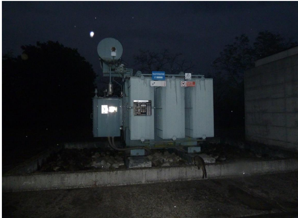
Foto 5 - Trasformatore MTMT dismesso nel 2009.
