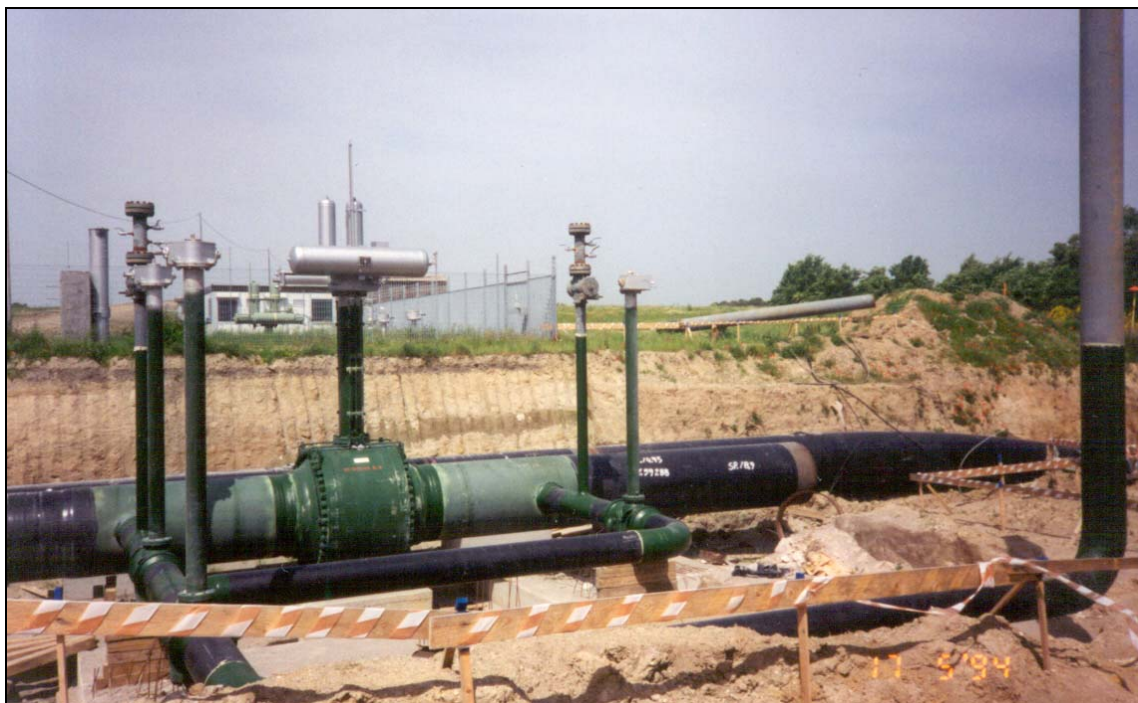
Foto 5.1/N: Impianto di intercettazione di linea (PIL)
