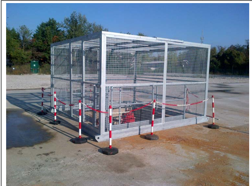
Figura 15. Gabbia metallica per protezione testa pozzo
