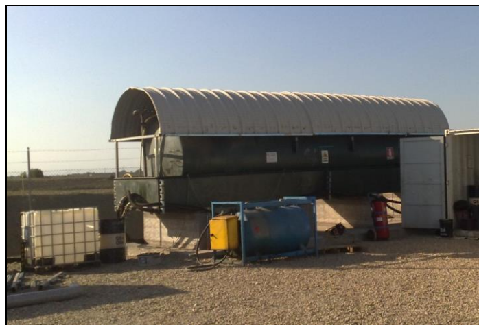
Figura 4.g: Esempio Serbatoio Gasolio
