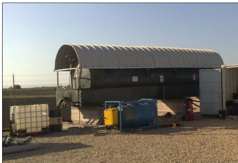
Figura 3.8.7: Immagine tipo di un deposito gasolio
