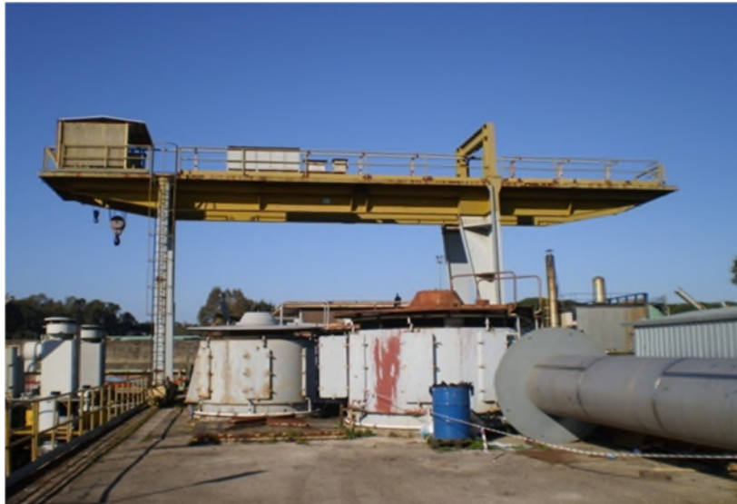
Figura 3/7 – Stazione di pompaggio acqua mare.
