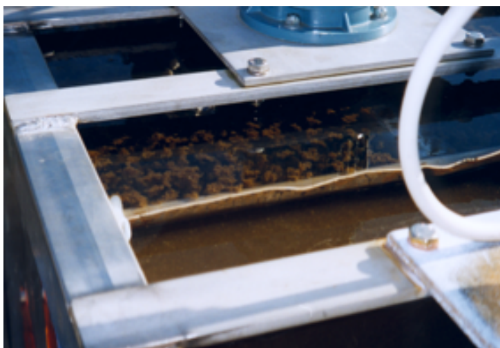
Figura 5. Flocculazione dell'acqua di controlavaggio dei filtri
