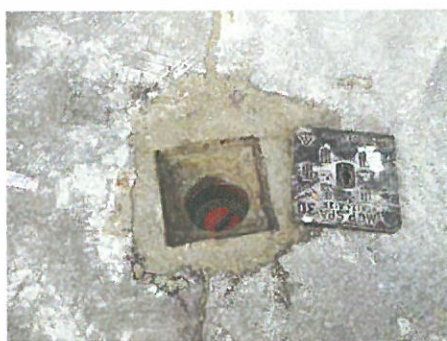
Pozzetto su PNNM02R04
