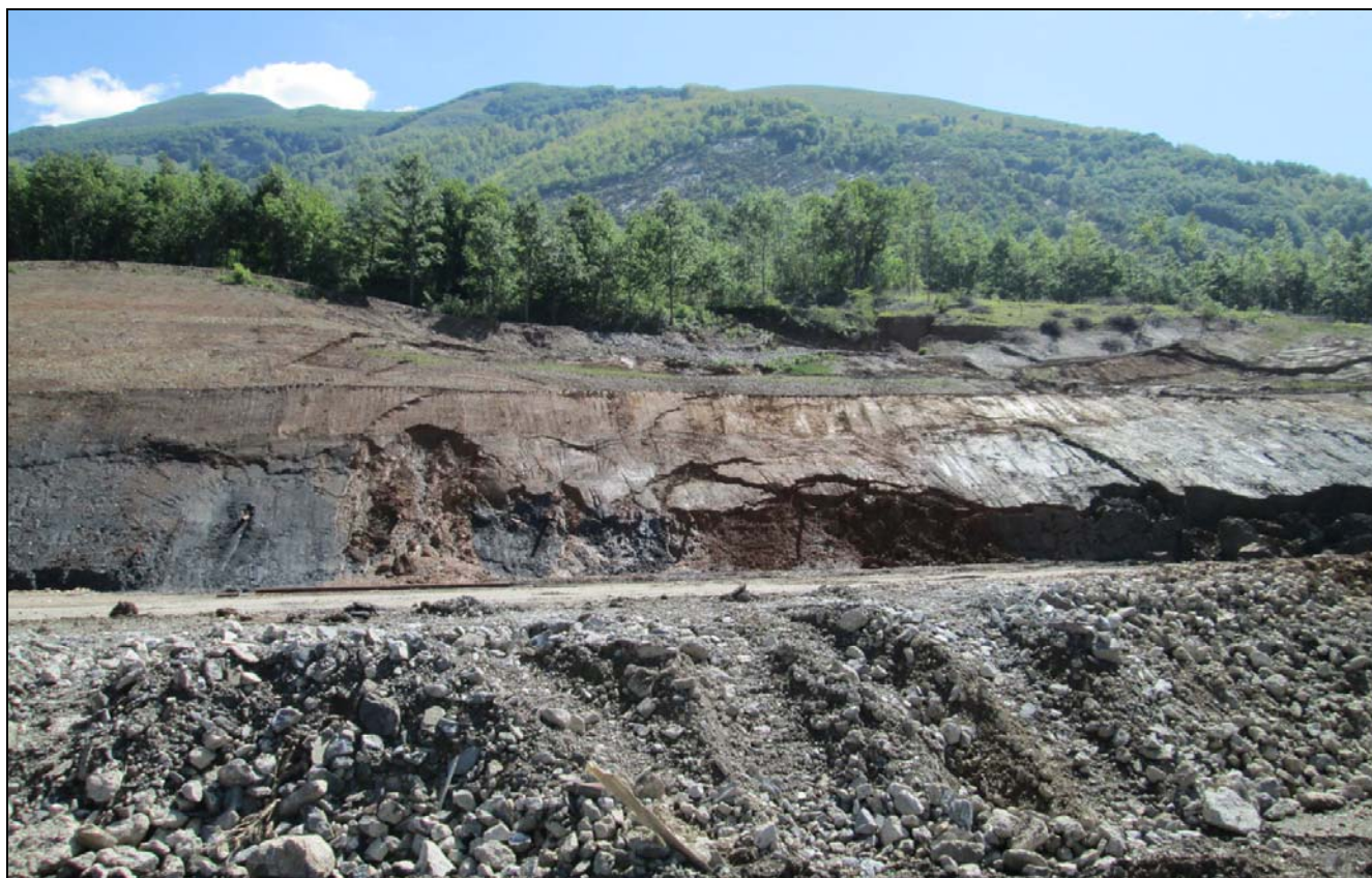
Figura 10: Tratto di scarpata coinvolto nel franamento, corpo stradale “CS36” su asse nord
