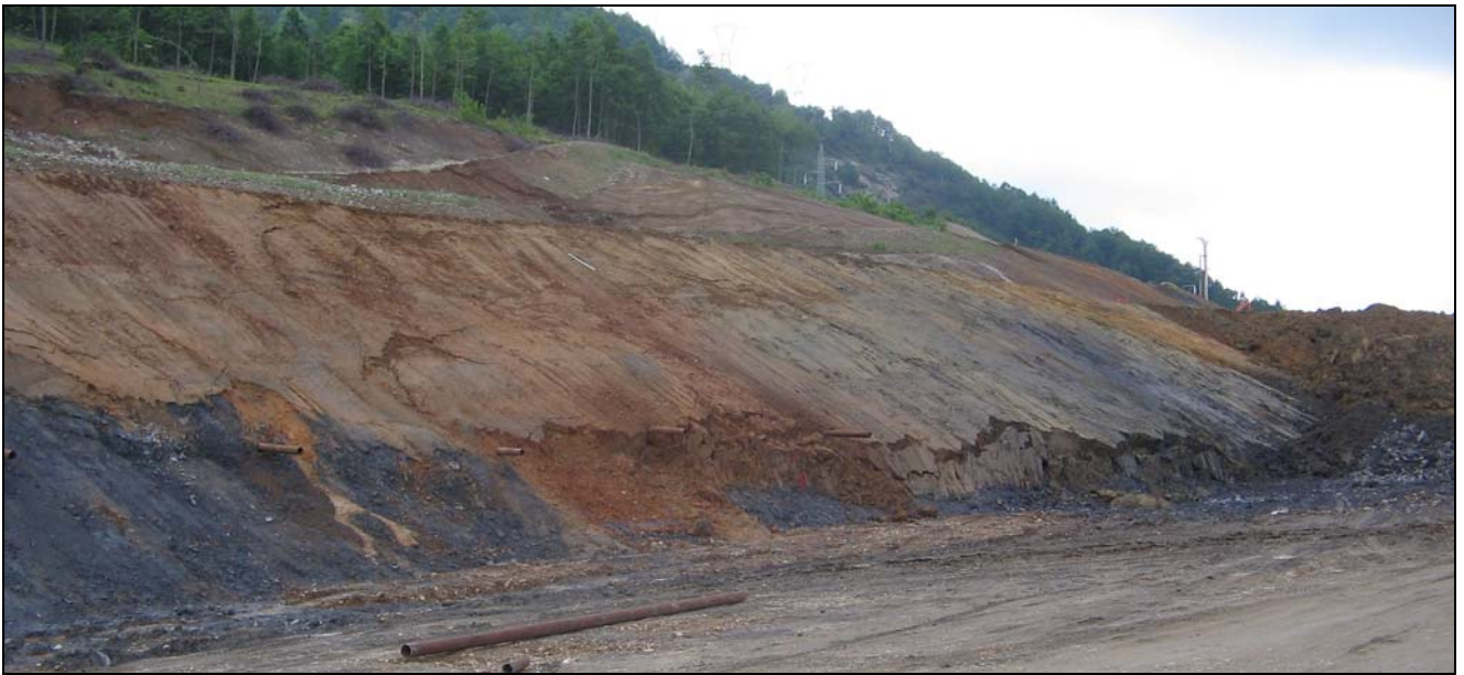
Figura 8: Fenomeni di dissesto delle scarpate 15/8, corpo stradale "CS36" su asse nord
