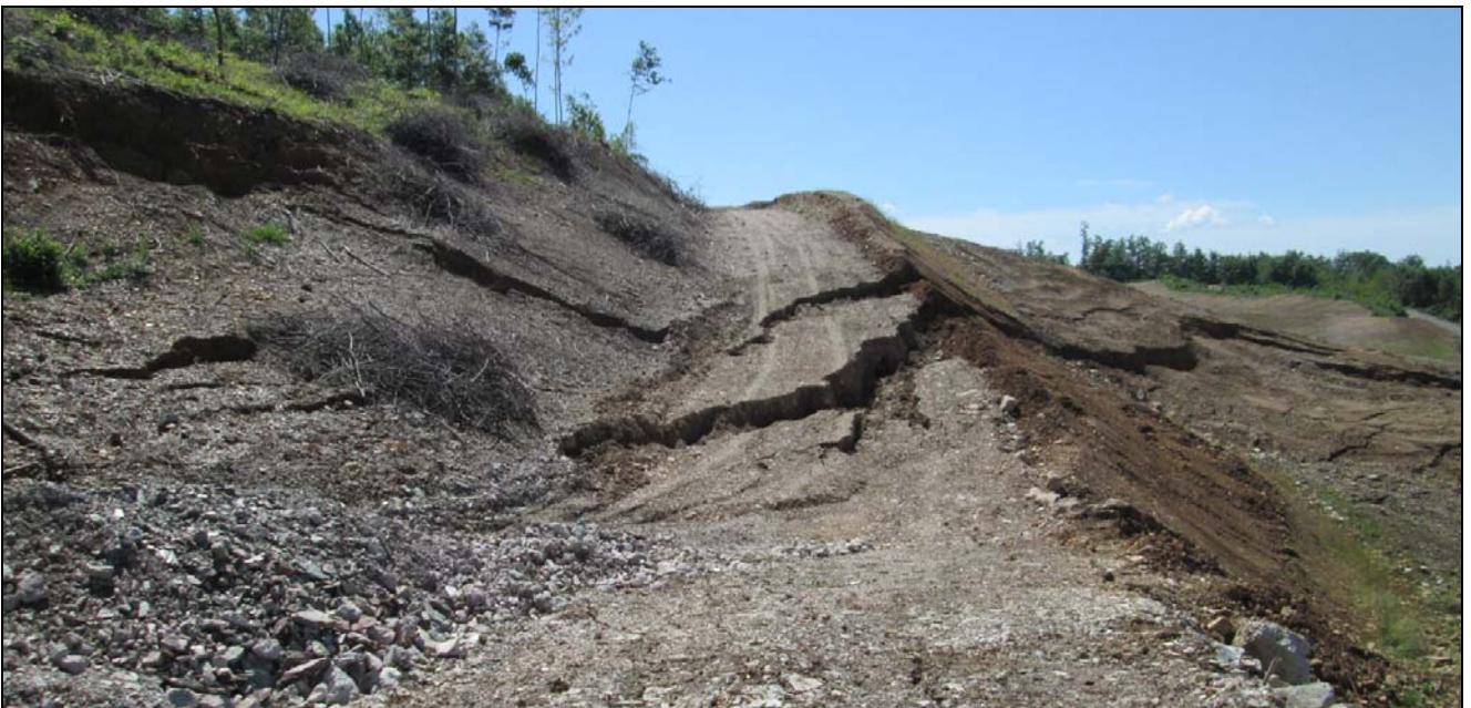
Figura 9: Evoluzione verso monte dei dissesti, corpo stradale "CS36" su asse nord
