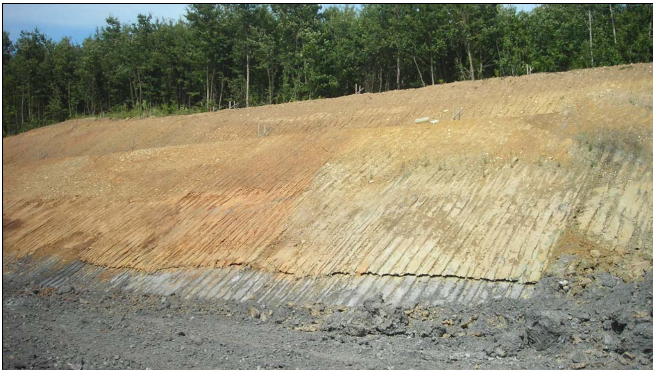
Figura 7: Dissesti delle scarpate 3/2 (primavera 2010), corpo stradale “CS36” nord
