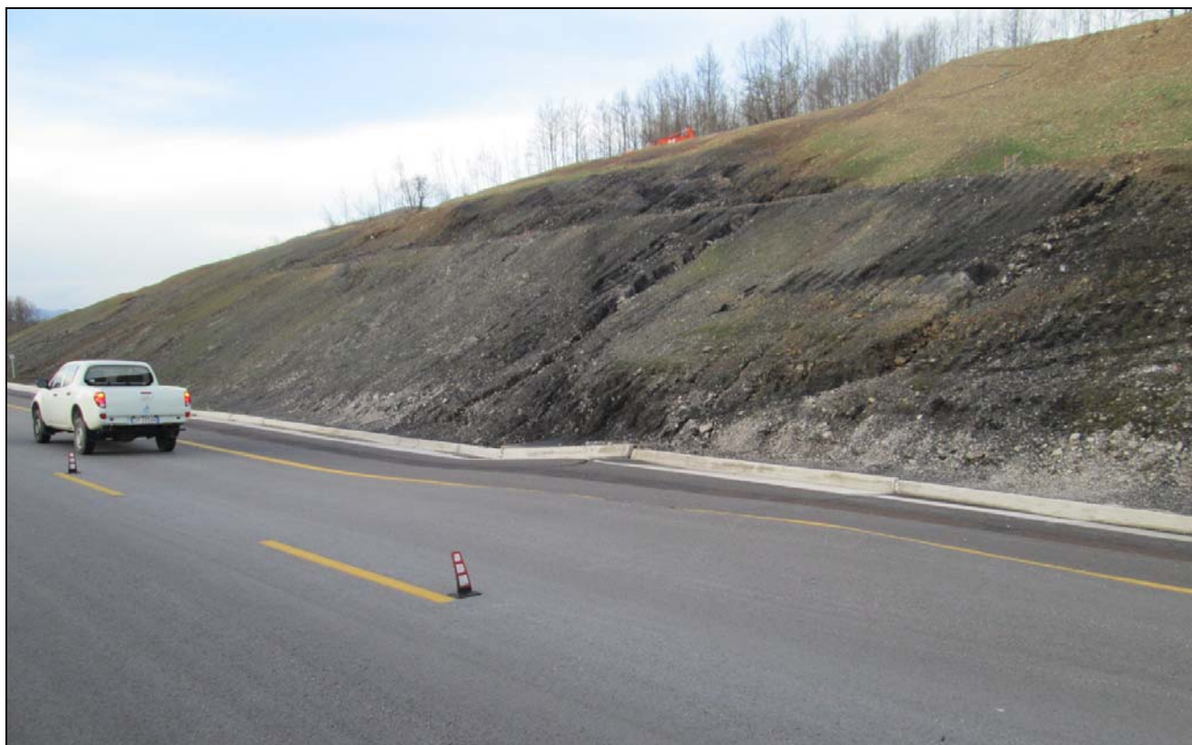
Figura 5: Sollevamento del piano stradale in carreggiata nord, area Taggine
