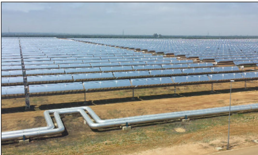
Figura 2: Impianto CSP esistente - Compensatori ad Omega
