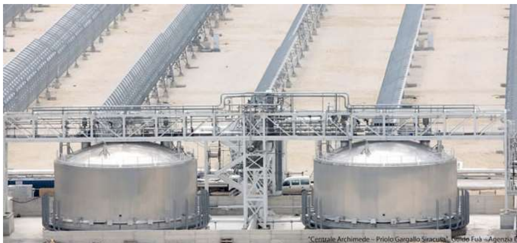
Figura 20. Serbatoi di Accumulo - Esempio
