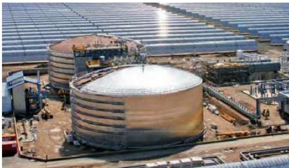
Figura 21. Serbatoi di Accumulo - Esempio
