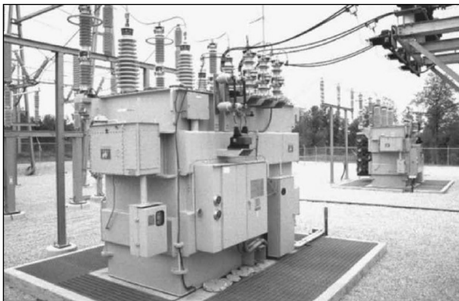
Figura 3: Trasformatori di potenza raffreddati ad olio con fosse di contenimento olio
