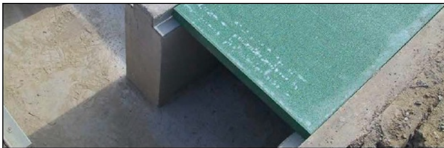
Figura 18: Esempio di copertura cunicolo cavi con PRFV
