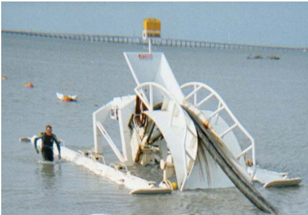
Fig. 9 Sistemi a getto per l'interramento di cavi sottomarini ( h > 10 ): Hydroplow (Prismian Proprietary).
