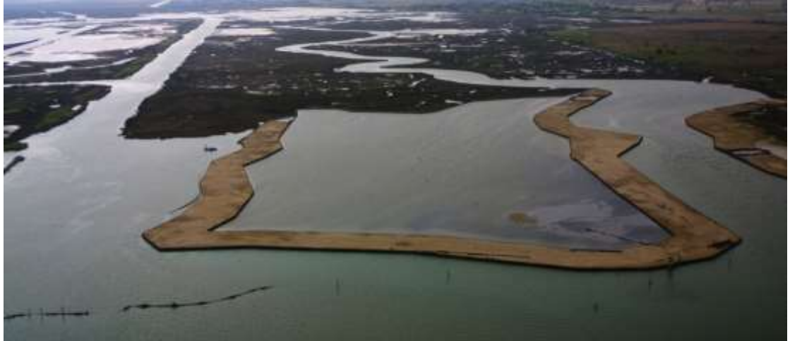
Figura 2-1 Barena Fusina 1: realizzazione della coronella esterna con sedimenti tipo A, che separa il nucleo centrale costituito da sedimenti tipo B (Magistrato alle Acque, 2008).
